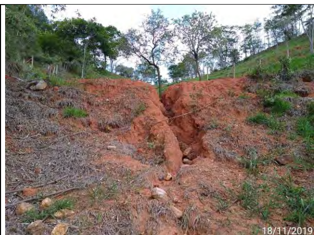
Foto 10- Detalhe do sulco/ravina formado pela concentração do escoamento pluvial.
