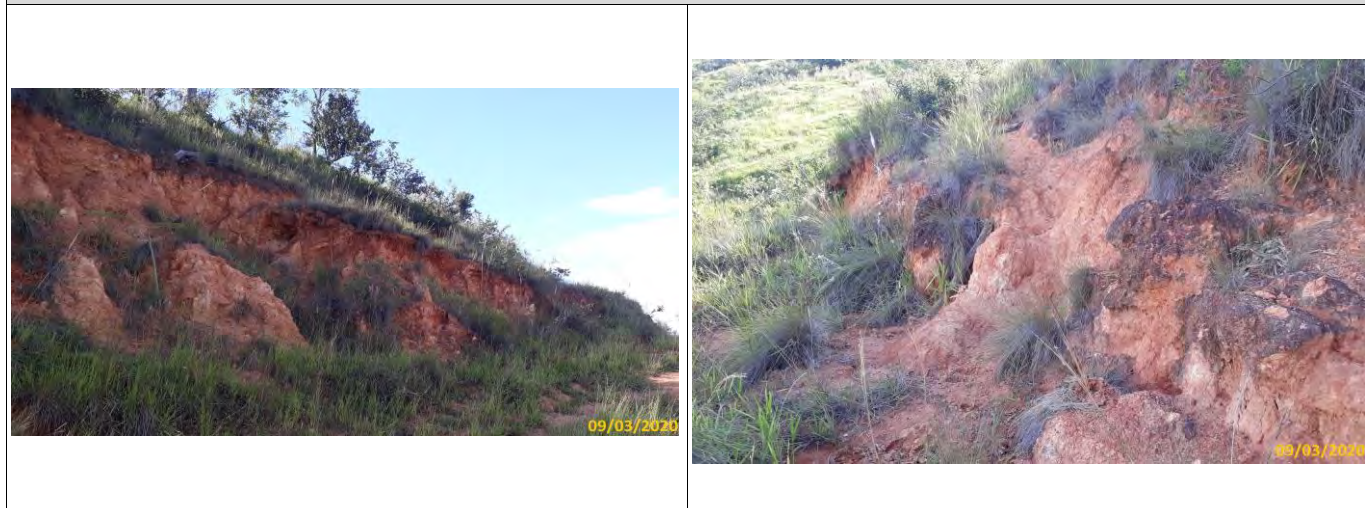
Foto 01 Vista geral do processo erosivo. Foto 02 Detalhe da área erodida.
