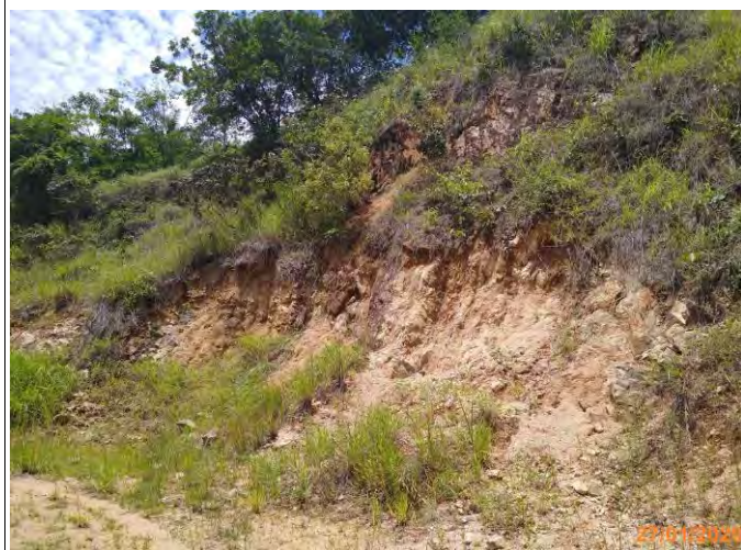
Foto 01 Vista das feições erosivas no talude.
