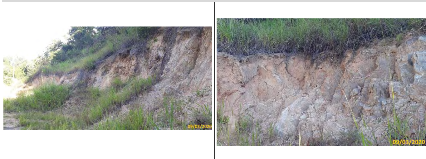
Foto 01 Vista das feições erosivas no talude. Foto 02 Detalhe do deslocamento rochoso.
