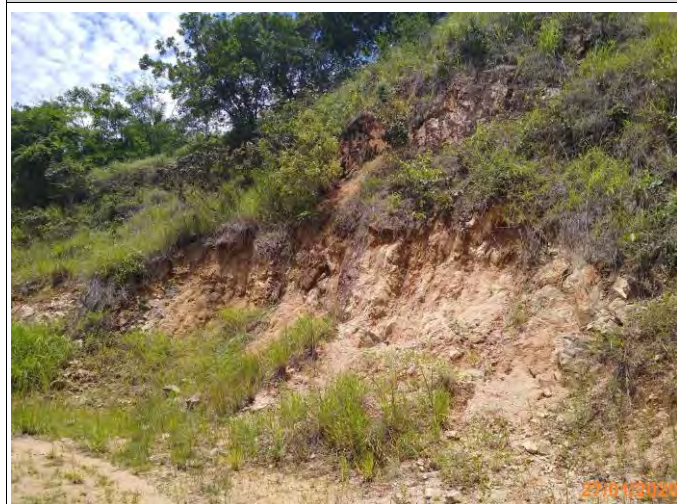
Foto 01 Vista das feições erosivas no talude.
