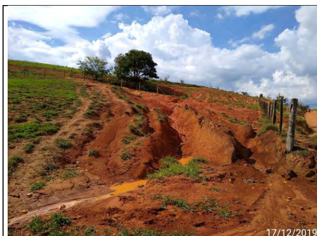
Foto 1 – Vista geral do processo erosivo.
